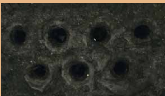
Scambiatore a tubi fumo tradizionale dopo pochi mesi di funzionamento (con incrostazioni di catrame)
